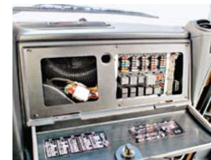
Монтажный блок с предохранителями и релюшками – как на ладони
